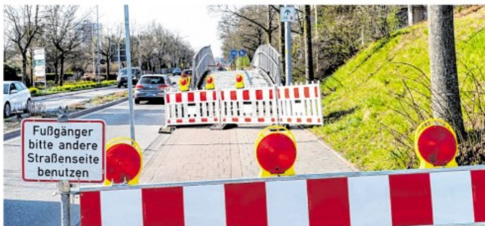
Die eingestürzte Brücke auf dem Radweg am Berliner Ring.
